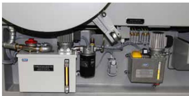
▼ Unidad de mantenimiento y centralita de lubricación automática por aceite
